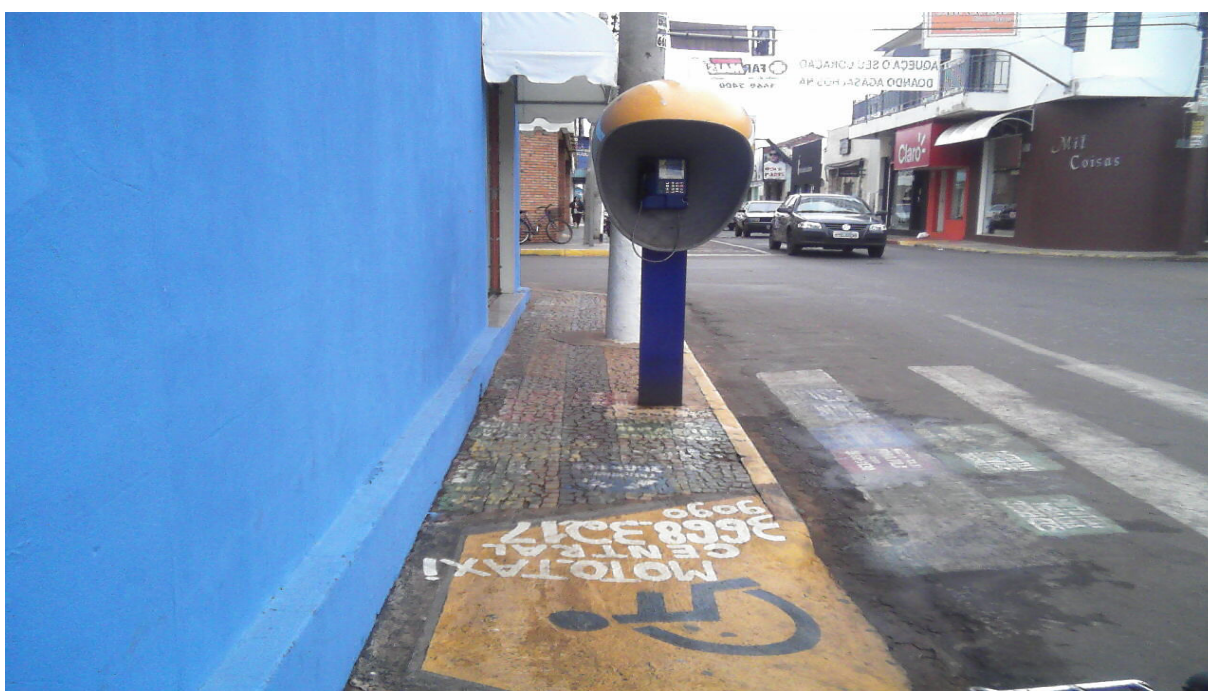
Fotografia 2 – Calçada estreita com previsão para cadeirante, mas com o padrão inadequado limitando o acesso.
